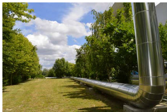
Réseau de vapeur au départ d'ECOSTU'AIR
