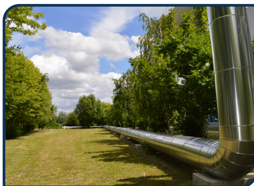
Réseau de vapeur au départ d'ECOSTU'AIR (thermique)
