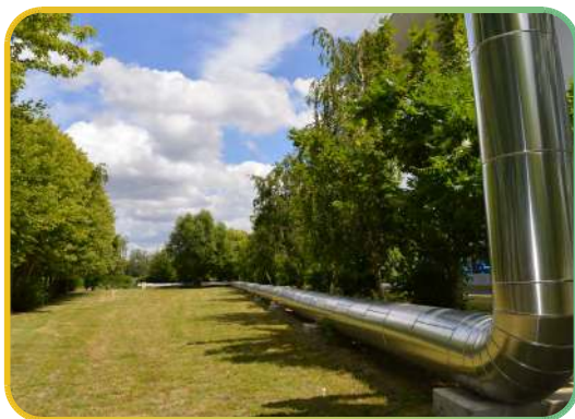
Réseau de vapeur au départ d'ECOSTU'AIR (thermique)
